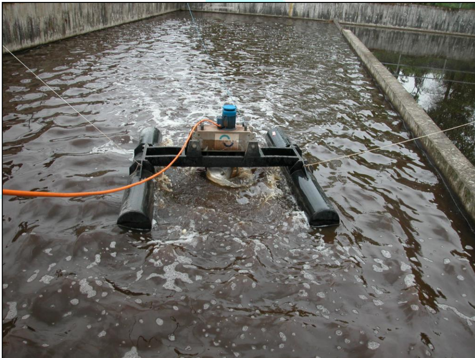
Illustration 1: OLOÏDE type 400 en fonction dans le bassin de stockage des lixiviats
