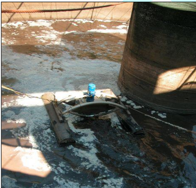
OLOÏDE Typ 400 A im Speicherbecken
