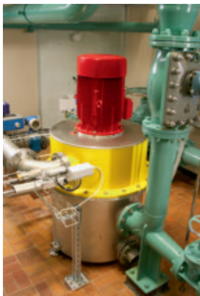
Fig. 8 Turbine Pelton à contre pression 14 kW.
