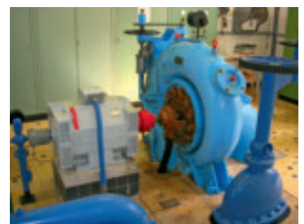
Fig. 6 Turbine Francis de 37 kW.
