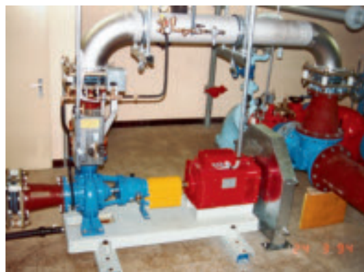
Fig. 9 Pompe inversée 15 kW.
